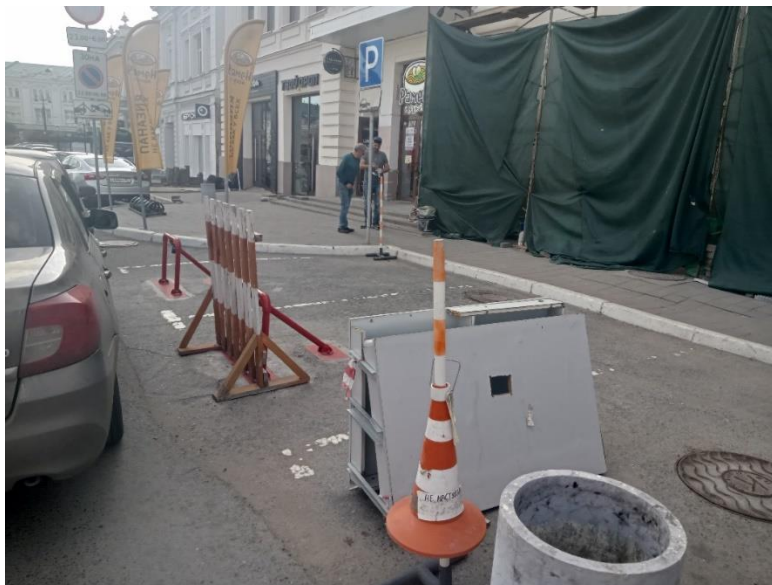
г. Омск, Центральный АО, в 6 м. южнее здания № 11 по ул. К. Либнехта
